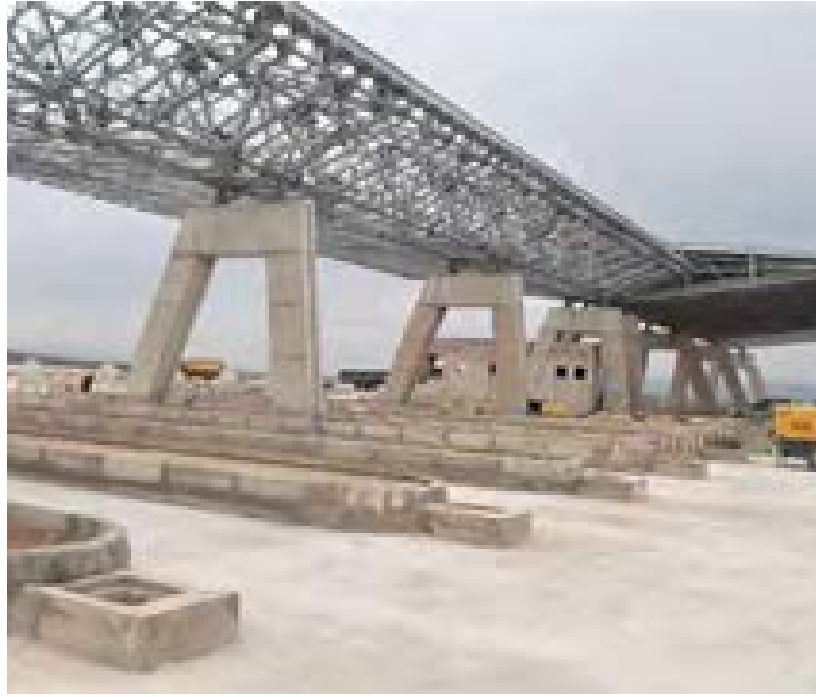
Instalaciones y sistemas para la explotación de la autopista Este-Oeste / Lote Oeste
