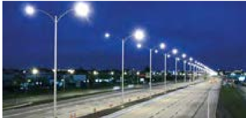
Modernización del alumbrado público en Valonia
