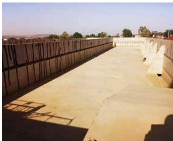
← Filtro de arena
