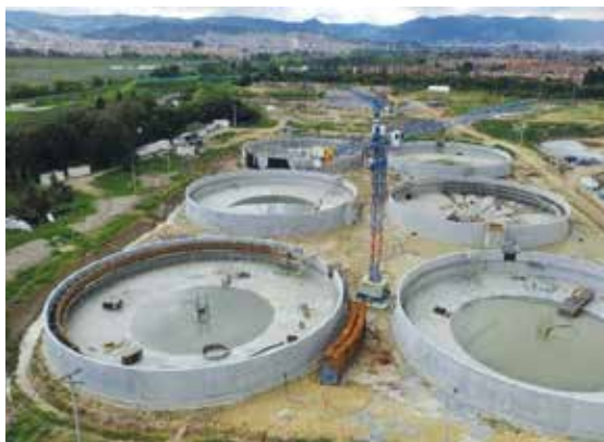
Ampliación de la planta de tratamiento de aguas residuales de El Salitre en Bogotá / Colombia
