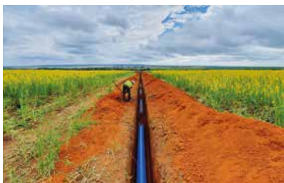
Proyecto de riego Samba Cajú
