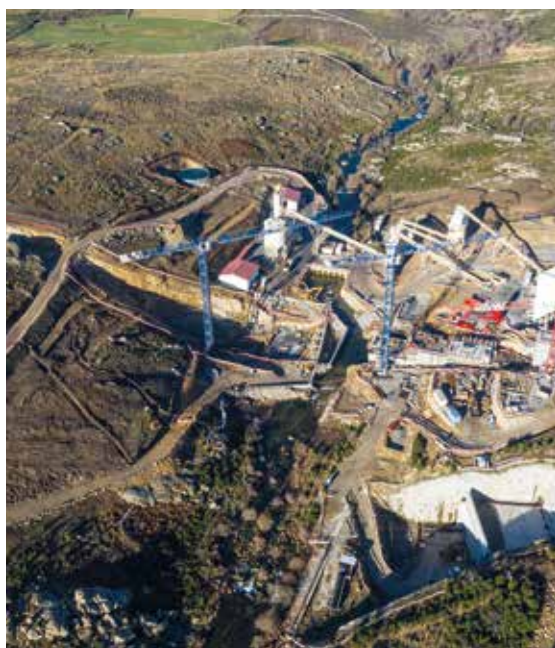
← Complejo hidroeléctrico del Alto Tâmega, Gouvães
