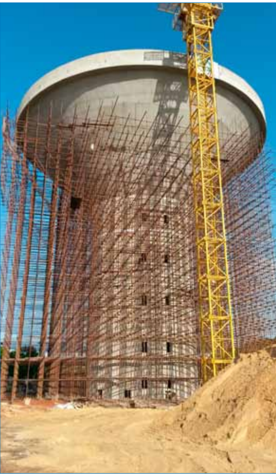
◀ Château d'eau de 3200 m 3 à Zinguinchor, Sénégal
